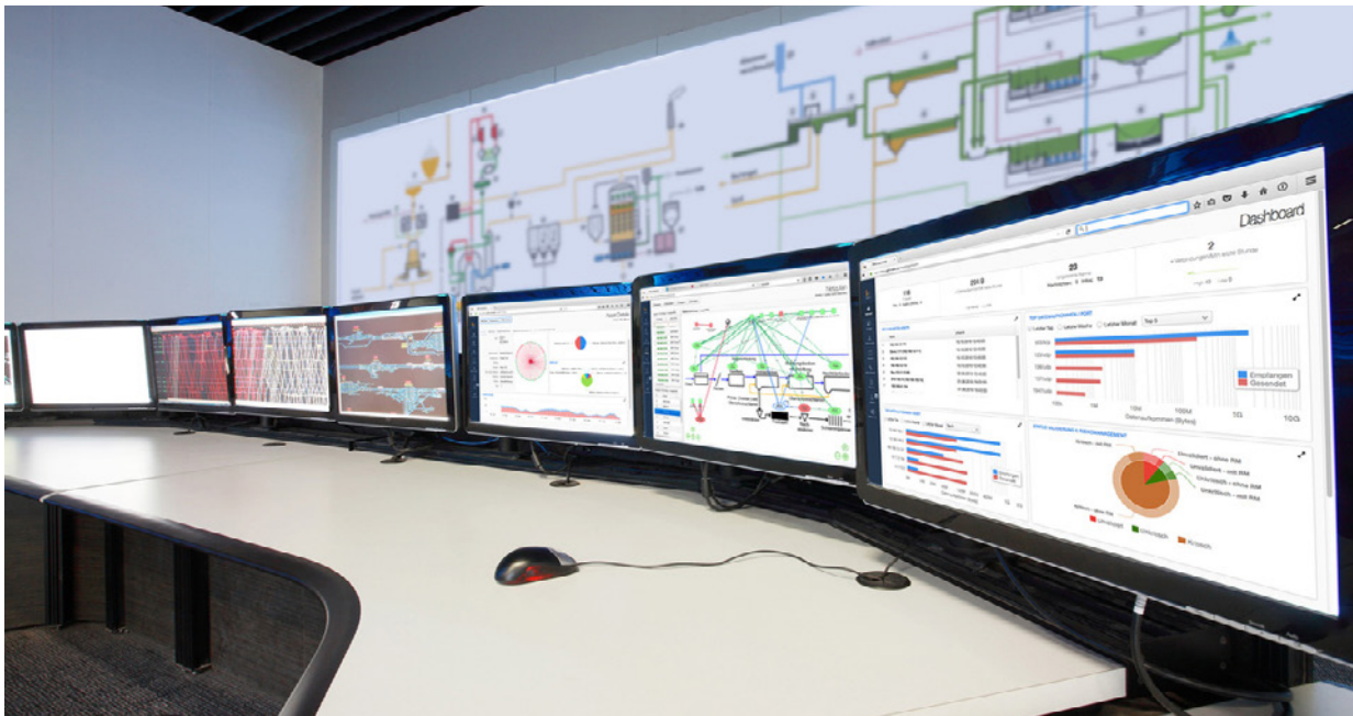
Bild 2: Einsatz von IRMA in einem Leitstand
